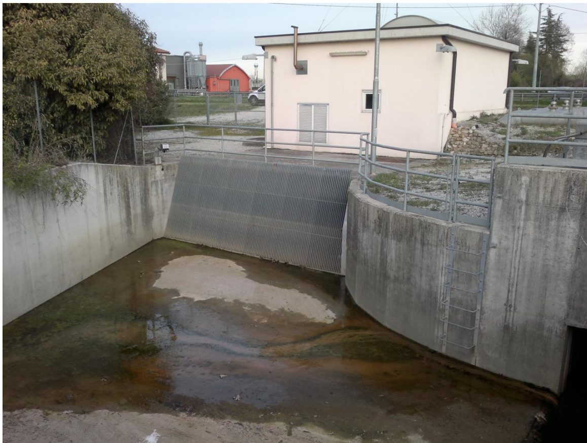
Figura 22. Impianto idrovoro Anconetta
